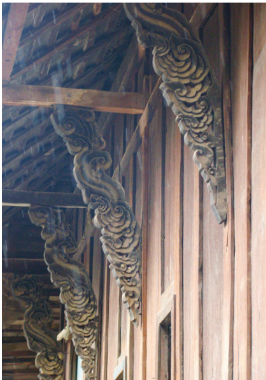
◆ ภาพที่ 18 ค้ำยันกุฏิวัดบ้านหลุก อำเภอเมือง จังหวัดลำพูน
